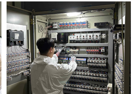
축사 제어기기 점검
